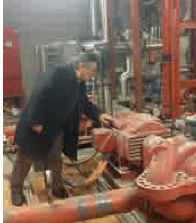
Yangın Tesisat ve Pompası Kontrolü
