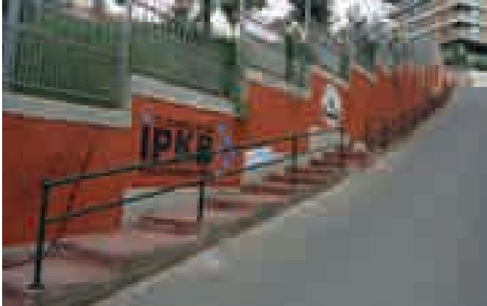
Ferahevler, Şehit Uğur Taşçı İ.Ö.O. Okul Dışı Merdiven Korkulukları
